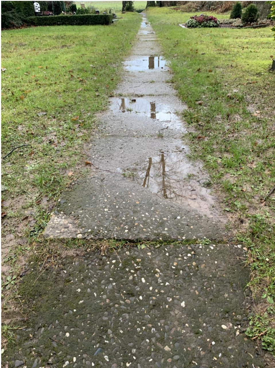
2. Bild 2 - Schlechter Zustand des Weges, der die Nutzung für Rollatoren erschwert.
